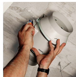
Instalacja głównego modułu wentylatora z puszką przyłączeniową zasilania
